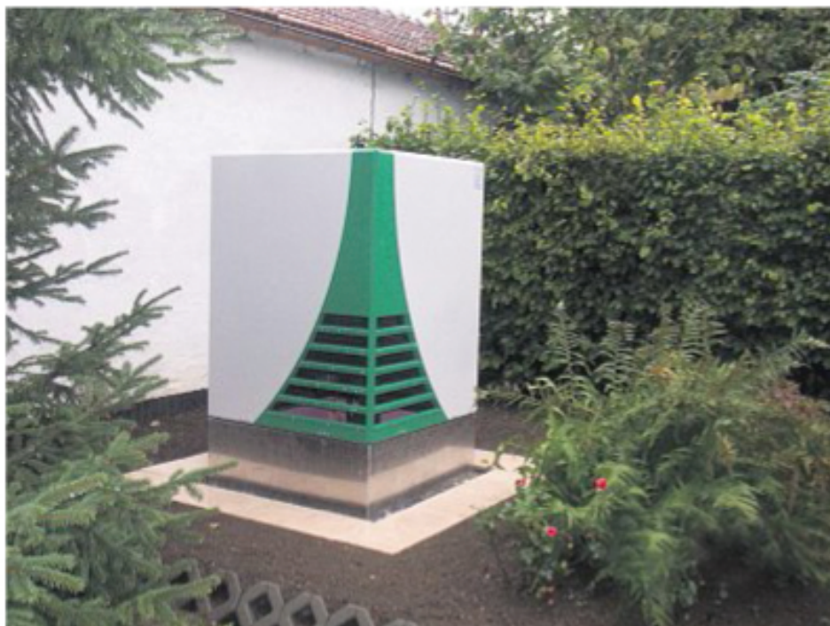
Die große „Wärmesammelanlage“ einer hocheffizienten Luftwärmepumpe.
